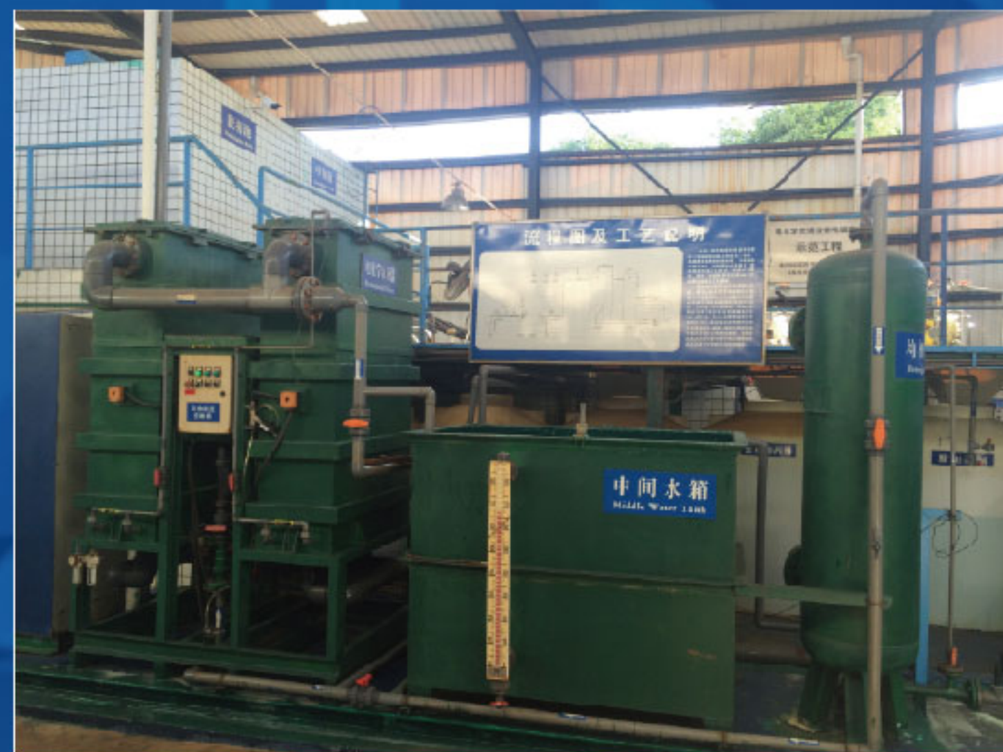
某市含铬电镀废水处理装备
